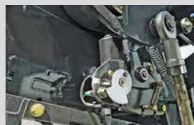
Электрическая система обвязки
